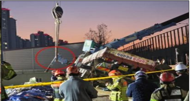
크레인 전도 사고 (2025. 12. 18.) 송파구 잠실대교 남단 · 작업자 1명 매몰 사망
