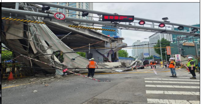
고가도로 붕괴 사고 (2026. 5. 26.) 중구 서소문동 · 사망 3명, 부상 3명
